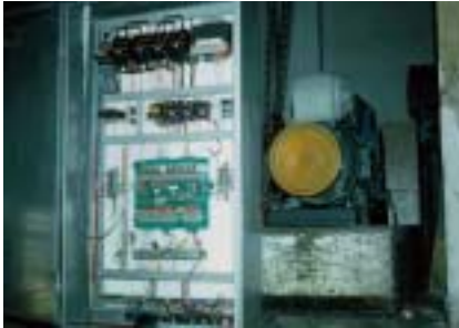
Control Ascensor Correo Central Cba.
